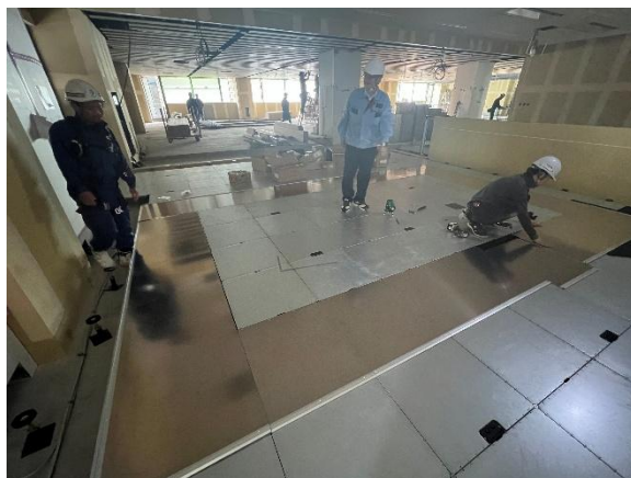
【2階指令室免震床の設置状況】
