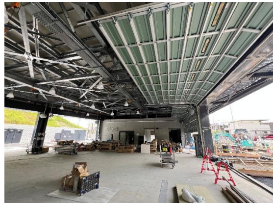
【本庁舎車庫シャッターの状況】
