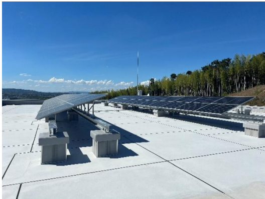
【屋上太陽光の設置状況】
